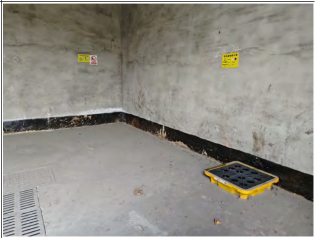
防泄漏托盘（危废暂存间）
