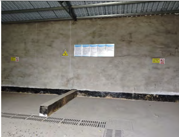
导流沟及防泄漏收集池（危废暂存间）
